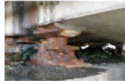
ひび割れ、腐食が進む古い橋梁 国土交通省中部地方整備局
